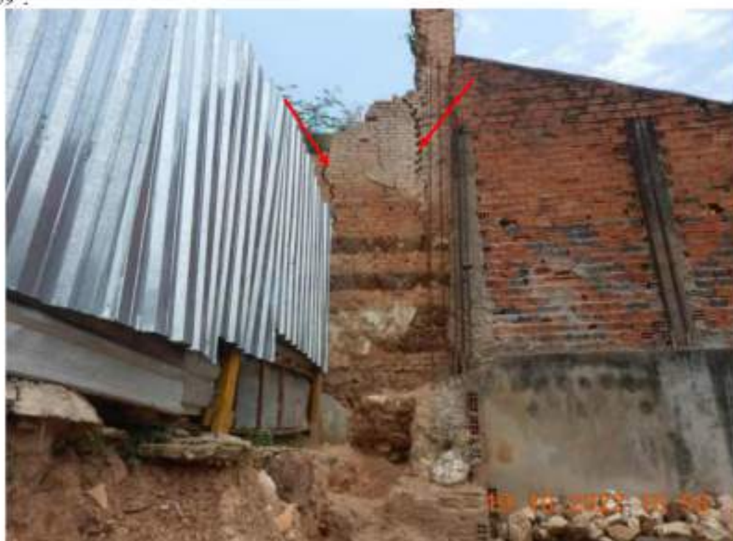
Figura 8 – Vista da área externa da edificação localizada na Rua Engenheiro Ricardo Franco, “Nº459”. Observar rachaduras (seta vermelha) na parede que fica nos fundos da edificação questionada.
