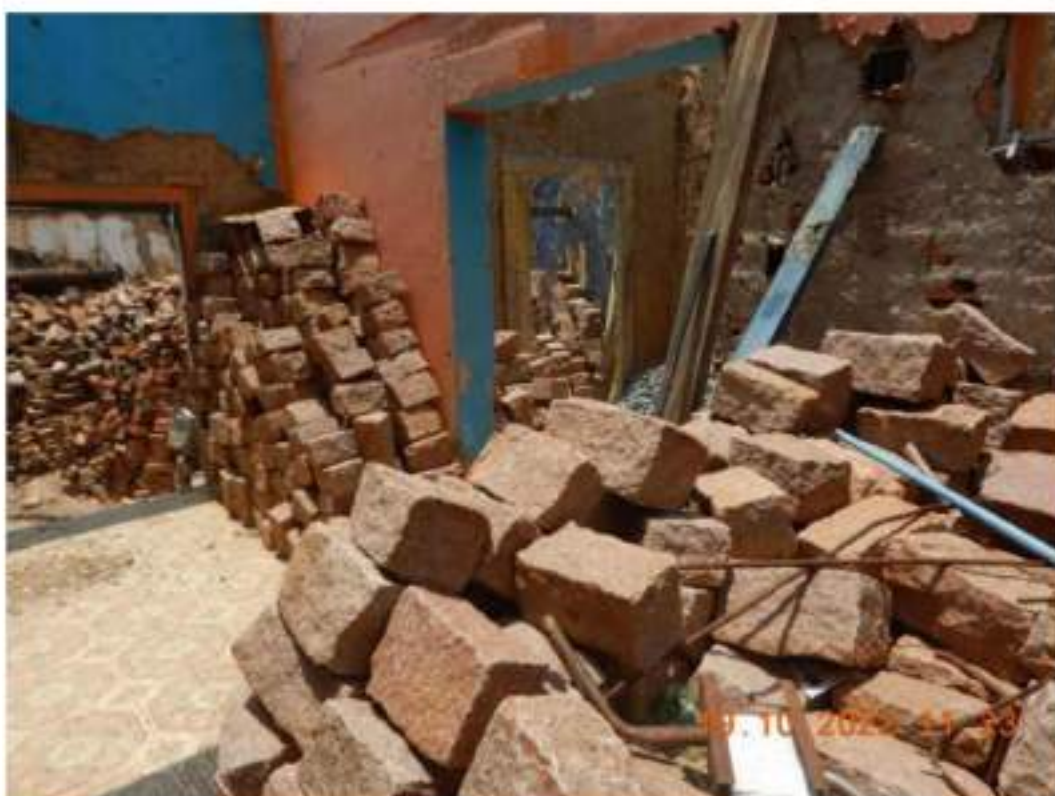
Figura 36 - Vista do interior da edificação localizada na Rua Engenheiro Ricardo Franco, “Nº608”.
