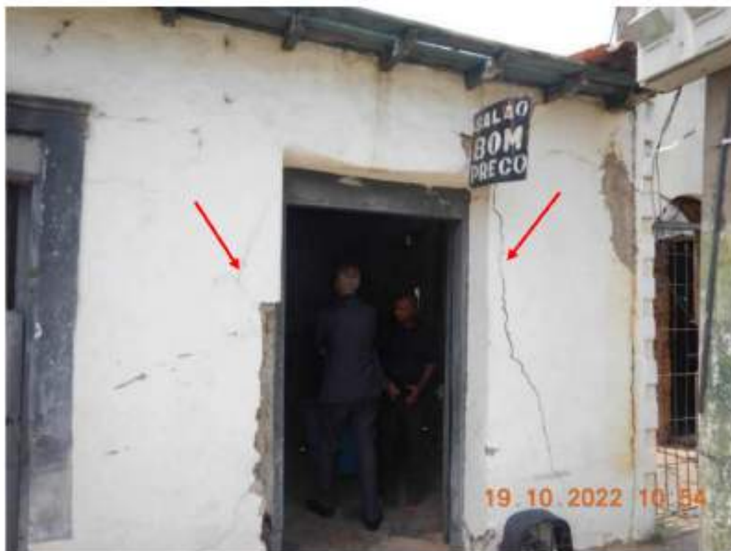
Figura 15 – Vista da entrada da edificação localizada na Rua Engenheiro Ricardo Franco, "Nº460". Observar rachaduras nas paredes (seta vermelha).
