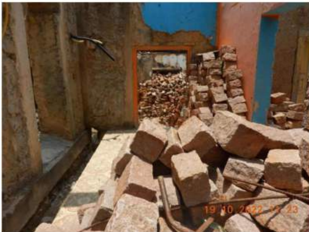
Figura 35 – Vista do interior da edificação localizada na Rua Engenheiro Ricardo Franco, “Nº608”.
