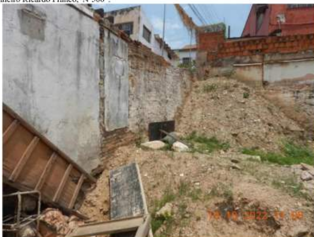
Figura 28 – Vista de entulhos depositados no interior da edificação localizada na Rua Engenheiro Ricardo Franco, “Nº500”.
