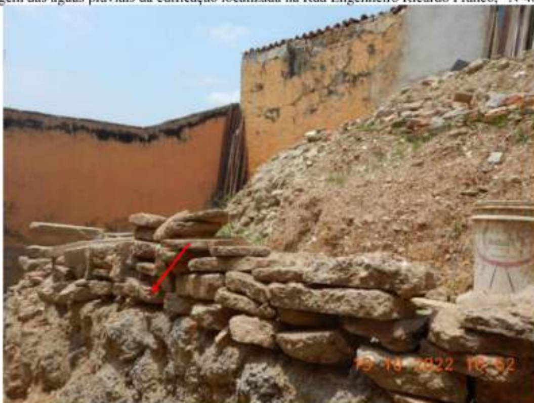
Figura 12 – Vista de muro de arrimo (seta vermelha) construído para evitar desmoronamento da parede que fica nos fundos da edificação localizada na Rua Engenheiro Ricardo Franco, “Nº461”.
