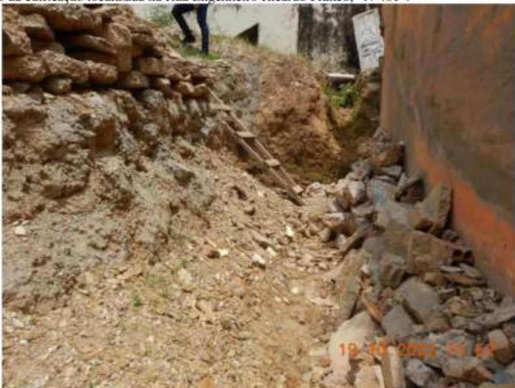
Figura 14 – Vista dos fundos da edificação localizada na Rua Engenheiro Ricardo Franco, “Nº461”.
