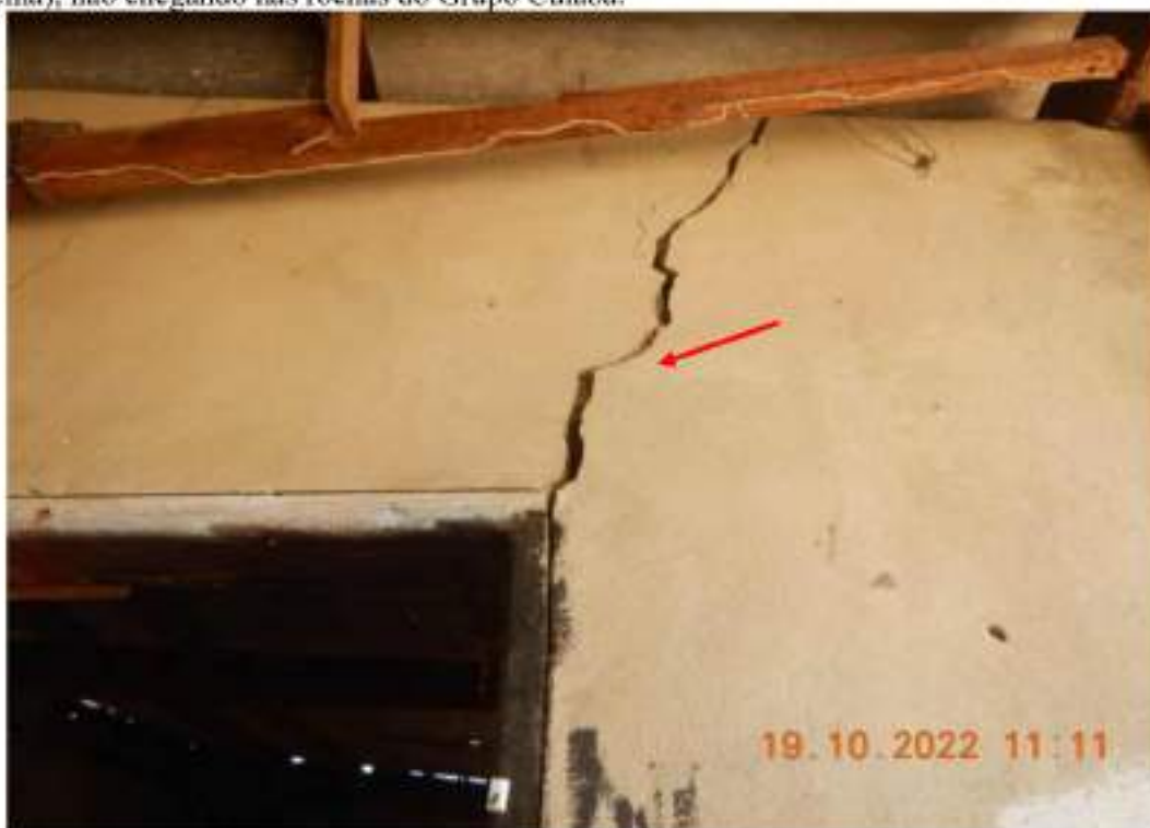
Figura 32 – Vista das rachaduras (seta vermelha) da edificação localizada na Rua Engenheiro Ricardo Franco, “Nº500”.
