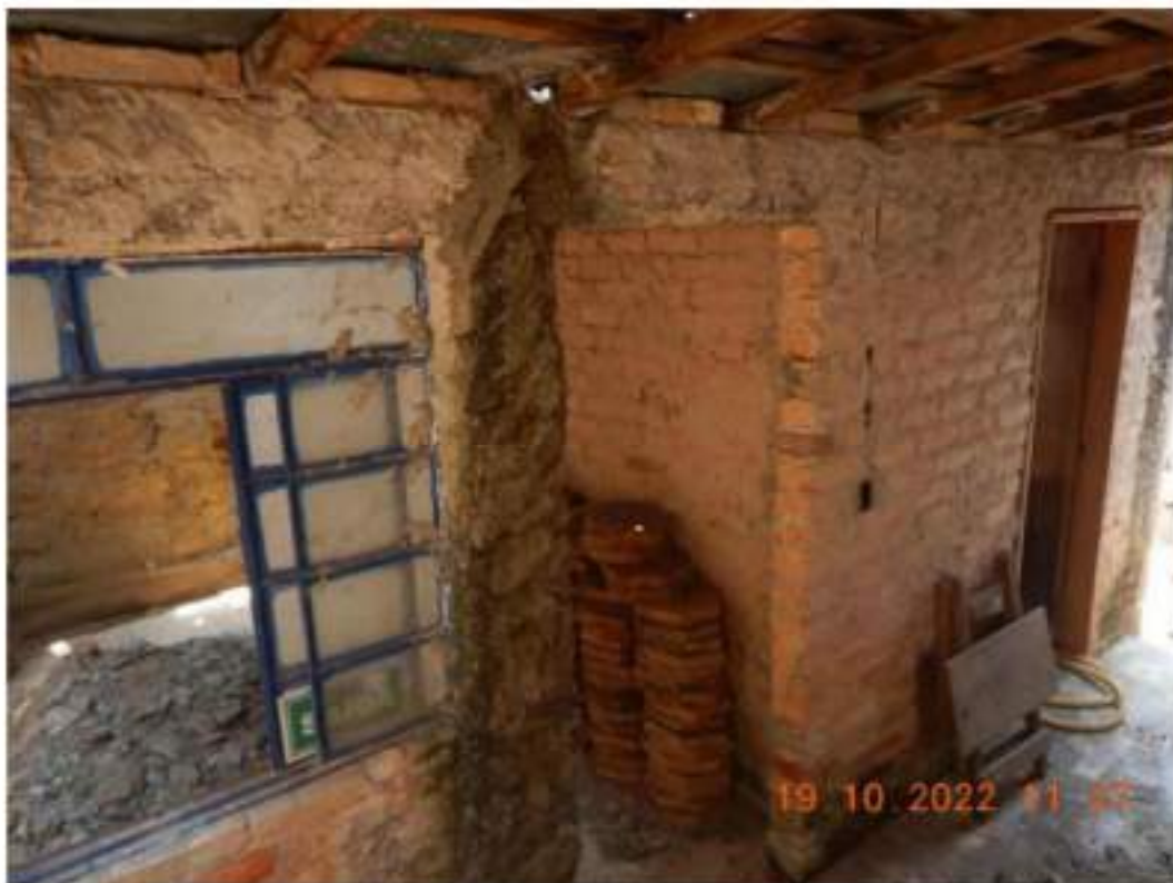
Figura 39 – Vista do interior da edificação localizada na Rua Engenheiro Ricardo Franco, "Nº600".
