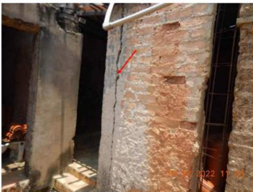
Figura 40 – Vista das rachaduras (seta vermelha) da edificação localizada na Rua Engenheiro Ricardo Franco, "Nº600".
